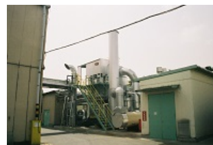
栃木サイト・VOC除去装置
