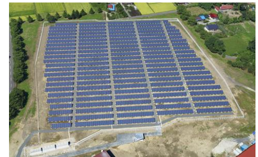
泉崎メガソーラー発電所
