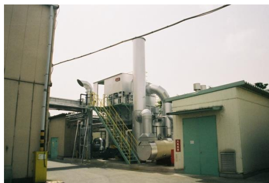
栃木サイト VOC除去装置
